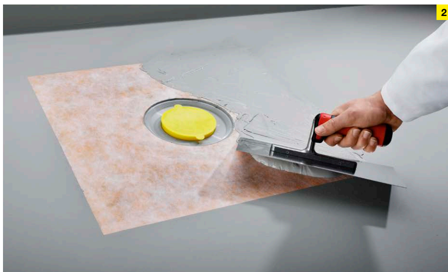
Nanošenje 2. sloja hidroizolacije s dvokomponentnom kombinacijom od umjetnog materijala i cementnog morta provjerenom u praksi.
