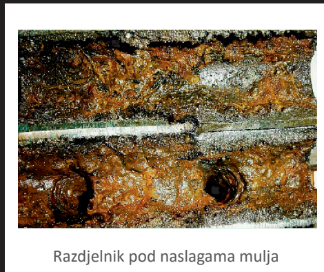
Začepljena cijev podnog grijanja
